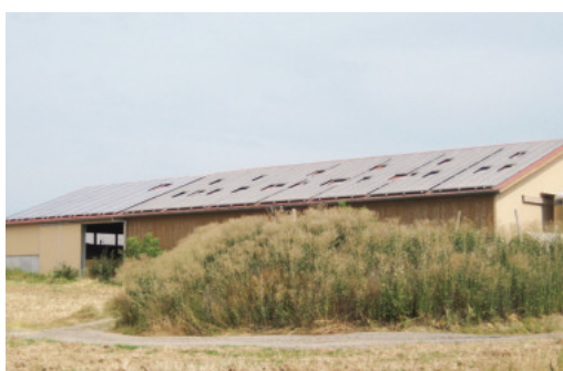
Abbildung 65: Photovoltaikanlage bei Neusetz
