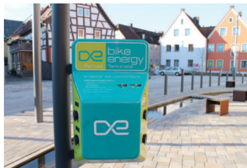
Abbildung 181: Beispiel E-Bike-Ladestation, Ortsmitte Kürnach
